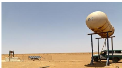
Instalación de bombeo solar en las inmediaciones de Tifariti (TTLL)
